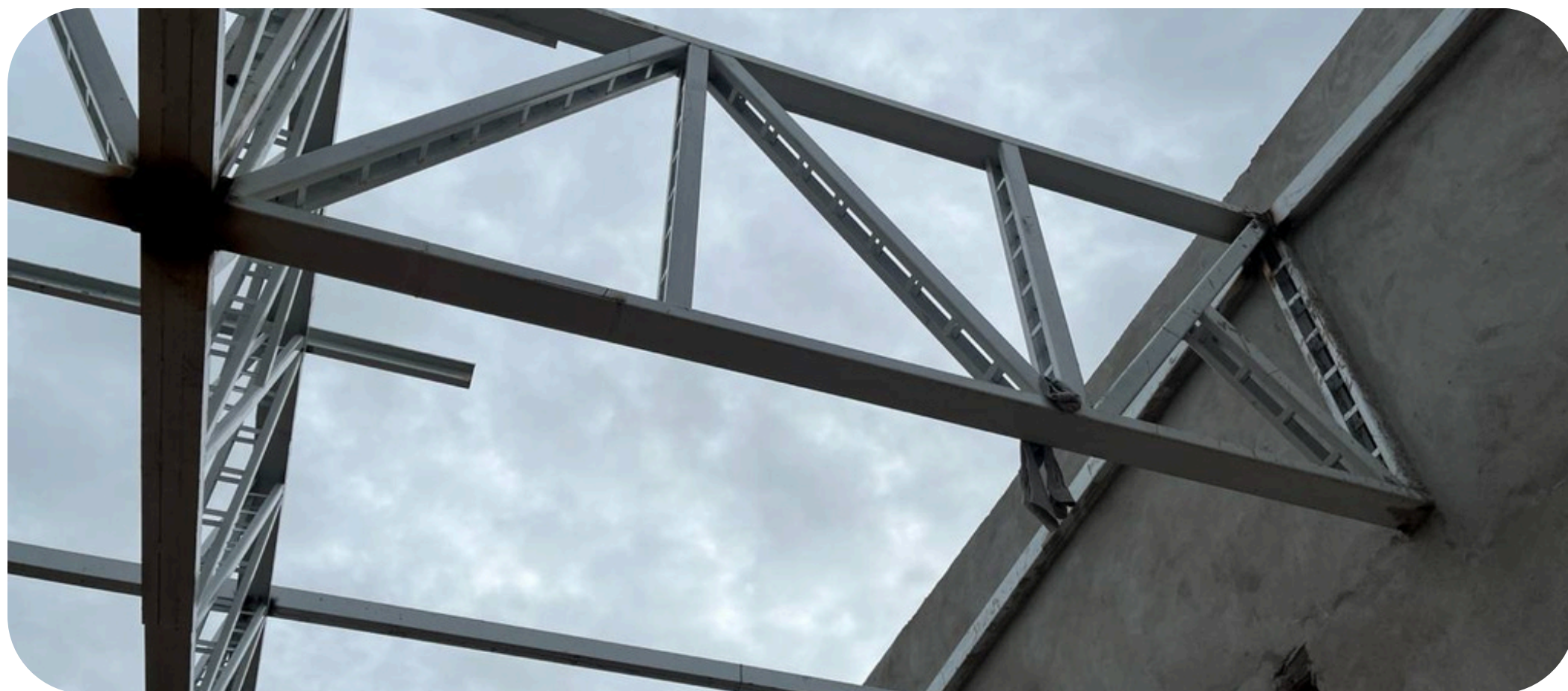
Figura 01 - Detalhes de soldas de campo a serem repintadas
